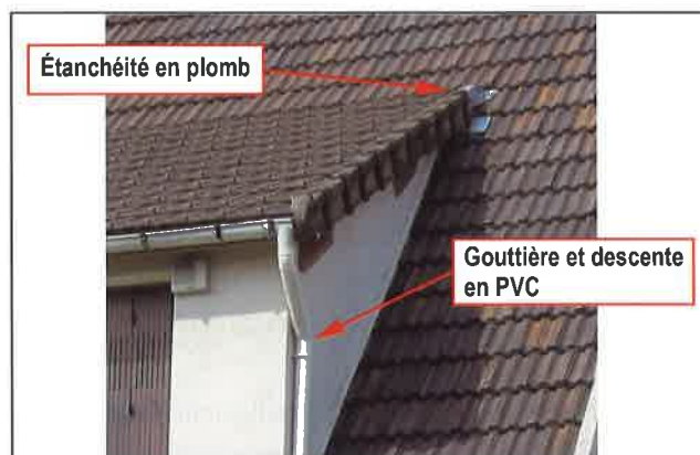
Figure 2. Exemple de toiture présentant des éléments en PVC et plomb
