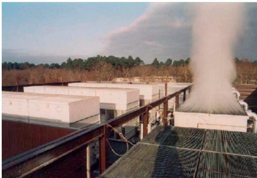
Exemple tour aéroréfrigérante.
