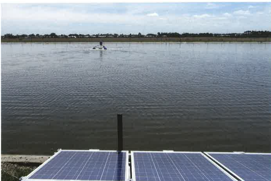
Le nouvel aérateur-circulateur solaire de Aquago, le Submix, a une capacité de brassage de 2 500 m 3 /h. Utilisé sur des lagunages naturels surchargés ou en dysfonctionnement, il a permis d'augmenter la capacité de traitement de 30 à 60 % selon les cas.
