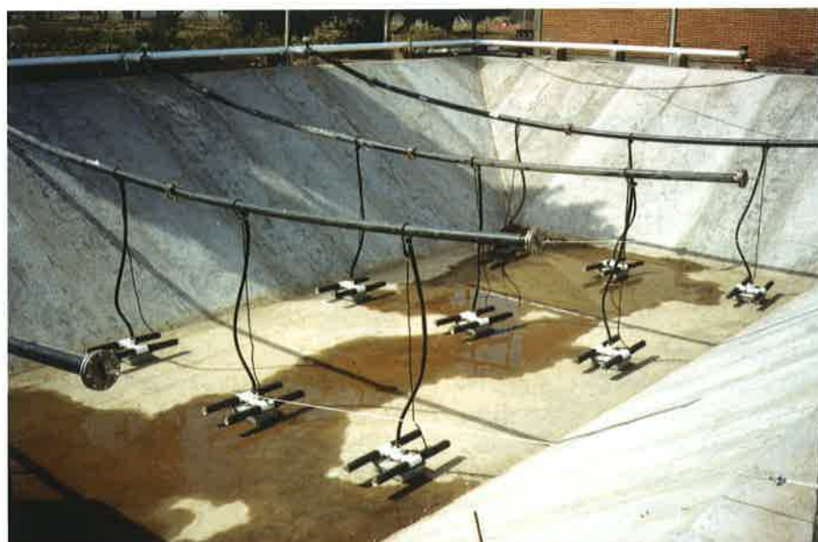
Nourrices flottantes pour aération par diffusion pour lagunage. Réalisation EDI Europe.
