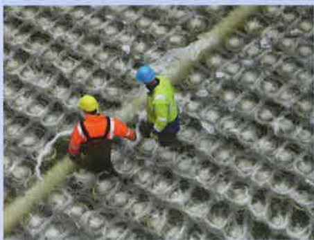
Installation de raquettes Grundfos, phase d'essai de bullage sur la station d'épuration de Paris.
