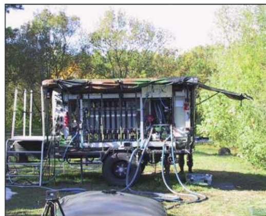
Figure 2. Module d'osmose inverse militarisé. Une ultrafiltration précède l'étape d'osmose inverse
