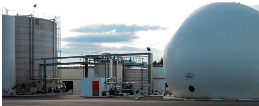
Unité de traitement par méthanisation des boues de la station d'épuration industrielle Louis Gad (29). Réalisation John Cokerill Proserpol.
