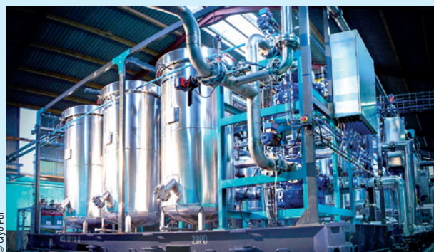
Installation Cryo Pur en Irlande du Nord.
