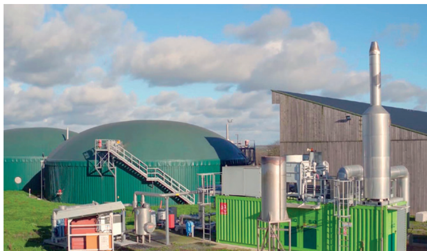
L'installation SAS MEETHA exploitée par SEDE dispose de la solution MethaZyme qui fluidifie la matière organique et réduit le coût d'agitation à court terme.
