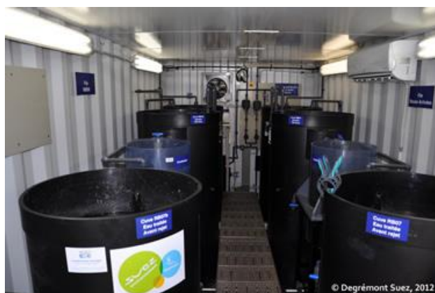
Figure 51 Pilotes de traitement Suez installés à la STEP de Bellecombe (source : Suez, 2012)
