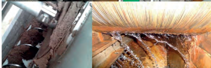
Adequatec mise sur la qualité de son procédé qui produit une boue déshydratée de bonne texture avec un filtrat très clair sans polymère résiduel, pour une faible consommation électrique, moins de 10 kWh/tonne de MS: Adequapress DH3200-STEP D'Idron (64), 50 à 90 kg MS/h, 0,68 kW, 8,5 kg PA/tonne MS.
