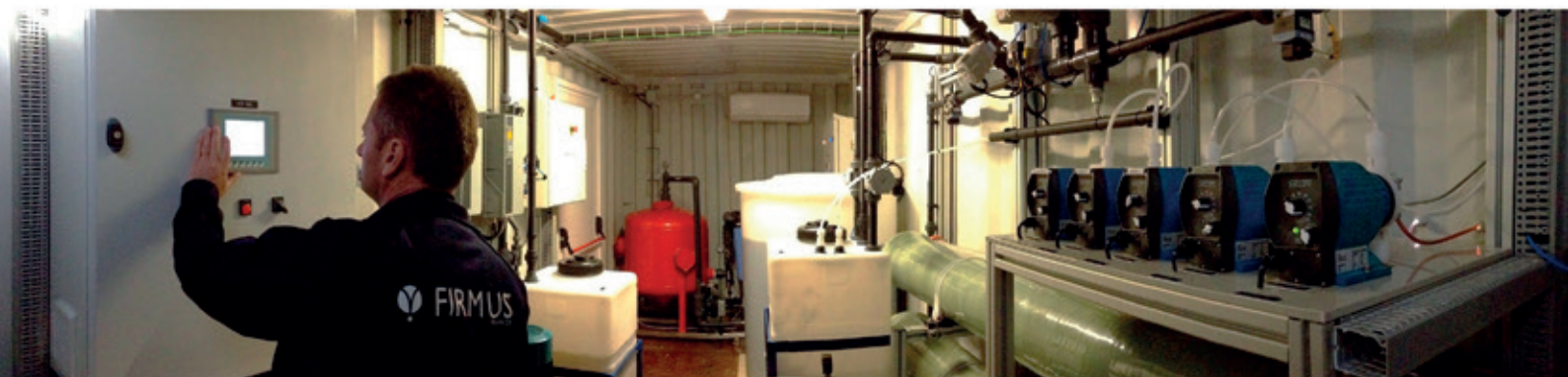
Container pour traitement de lixiviat (Capacité 120 m³/jour)
