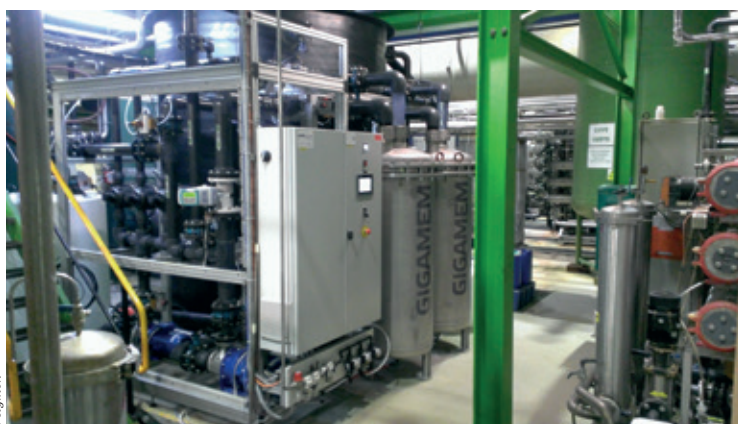
Vue de l'unité Gigamem chez Circuit Foil Luxembourg (fabricant de feuilles de cuivre pour les industries de haute technologie) pour la recirculation des eaux de procédé.
