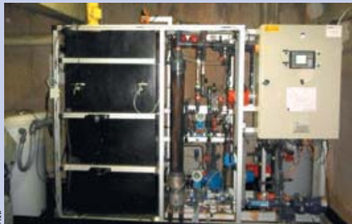
Procédé de traitement implanté au pavillon Dieulafoy à Purpan (CHU Toulouse).
