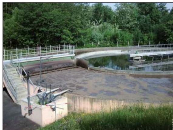
Figure 1. Photographie de la station de traitement des eaux usées étudiée (STEU) : bassin d'aération en périphérie, équipé d'un aérateur par brosse ; décanteur secondaire au centre
