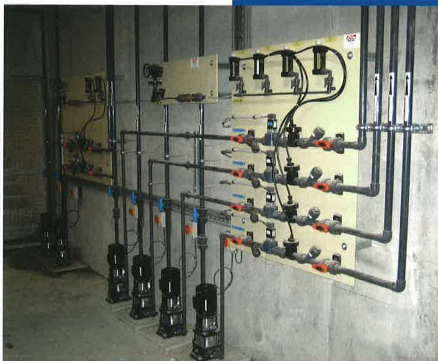
Panneaux de chloration pour 2 + 4 bassins. réalisation CIR.
