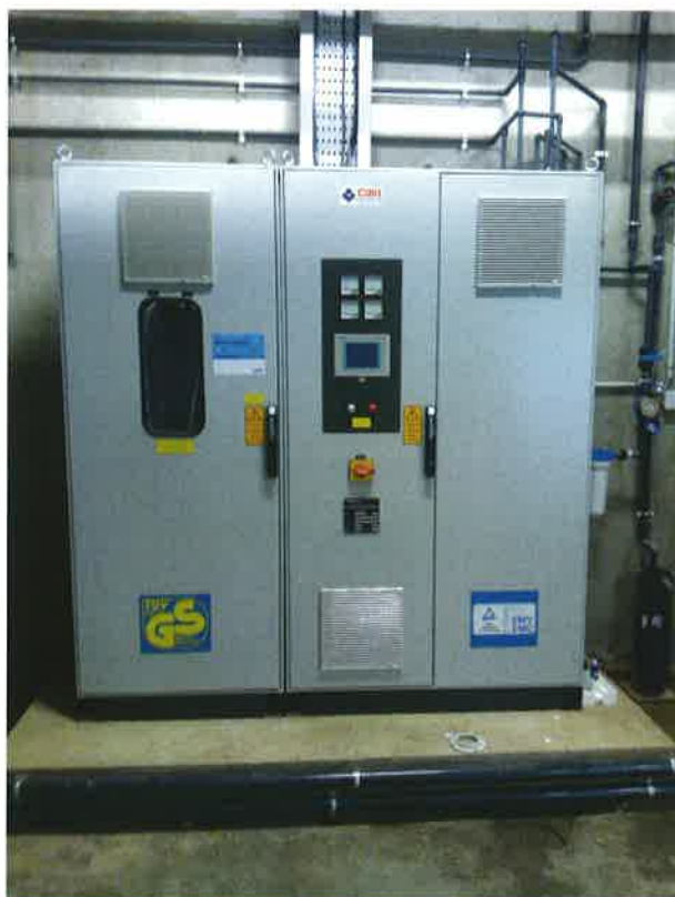
L'ozonation permet d'économiser jusqu'à 60 % d'eau de recirculation, que ce soit avant ou après l'étape de filtration (pré ou post-ozonation). Selon Cillit, la pré-ozonation est plus intéressante car elle retarde le colmatage des filtres.
