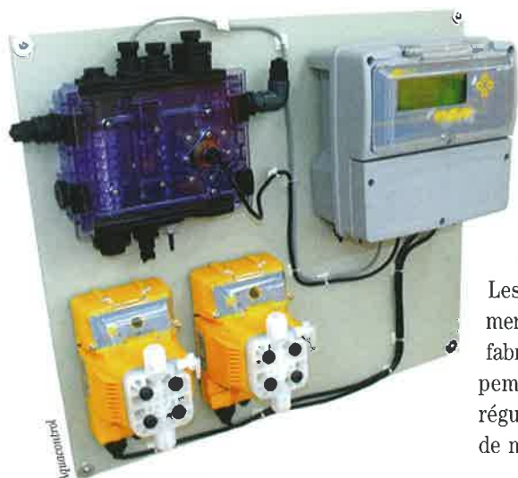
Panneaux de régulation du chlore par mesure ampérométrique et pH avec pompes doseuses. Réalisation Aquacontrol.
