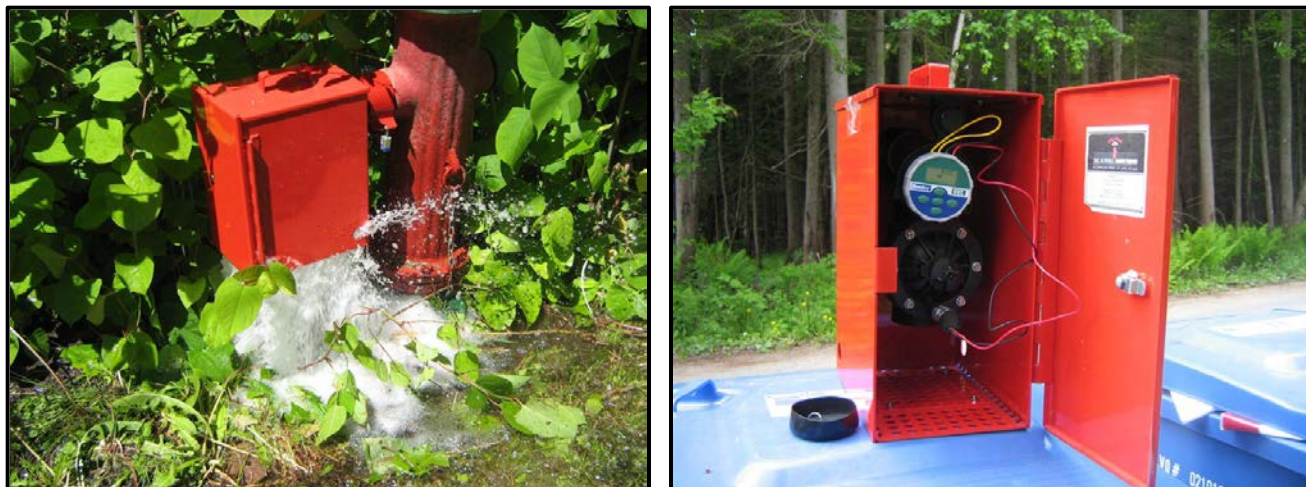
Figure 4- 3 – Purges programmables sur poteau d'incendie (Source : Ville de Québec)
