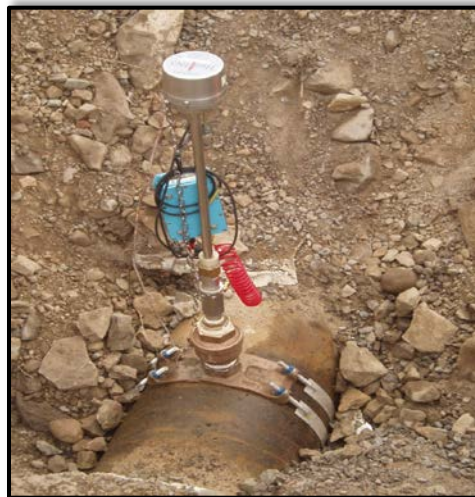
Figure 2-1 – Exemple d'installation en mesure temporaire sur le réseau
