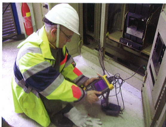
Exemple de mesures énergétique à l'aide d'un analyseur portable (appareil Fluke).
